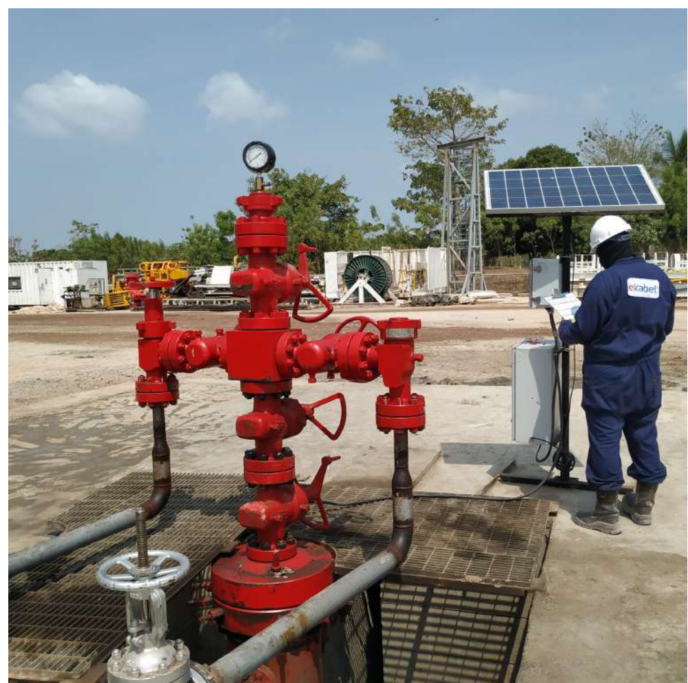
Detalle de adaptación a sistema Well-Dttek
